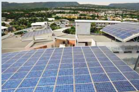
Panneaux solaires à l'île de la Réunion
